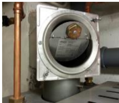
Bild 28. Motdragslucka monterad på förbindelsekanalen panna/skorsten
