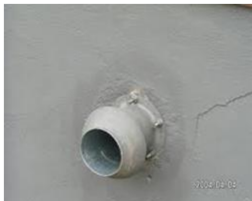
Bild 20. Inblåsningsrör med sk hankoppling
